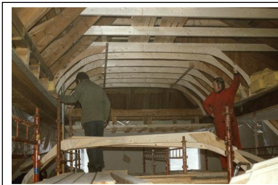
Per E. Ulriksen og Einar Berge monterer "ribbene" i himlingen i Logesalen
